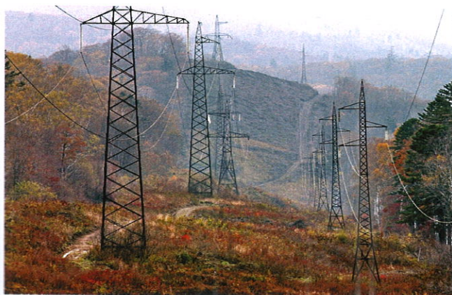
Рисунок 4 — Линии 220 кВ Крымского энергомоста, Краснодарский край, 2016 г.
